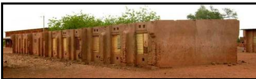
Nomgané, Bloc à 3 salles de classes, Toiture arrachée par le vent il y a 3 ans, Entretien défaillant. Photo : Wyss, 2005
